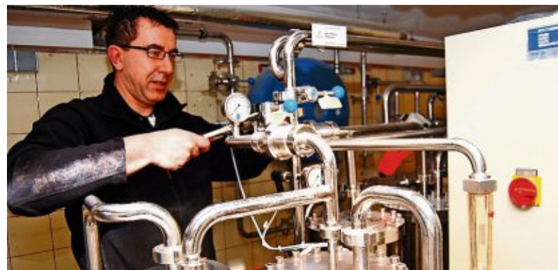
Dialyse-Patienten sind auf gereinigtes Wasser angewiesen. Deshalb steht im Keller eine Umkehr-Osmose-Anlage, die etwa alle Mineralien herausfiltert. Das Archivfoto zeigt, wie die Anlage gerade gewartet wird.
